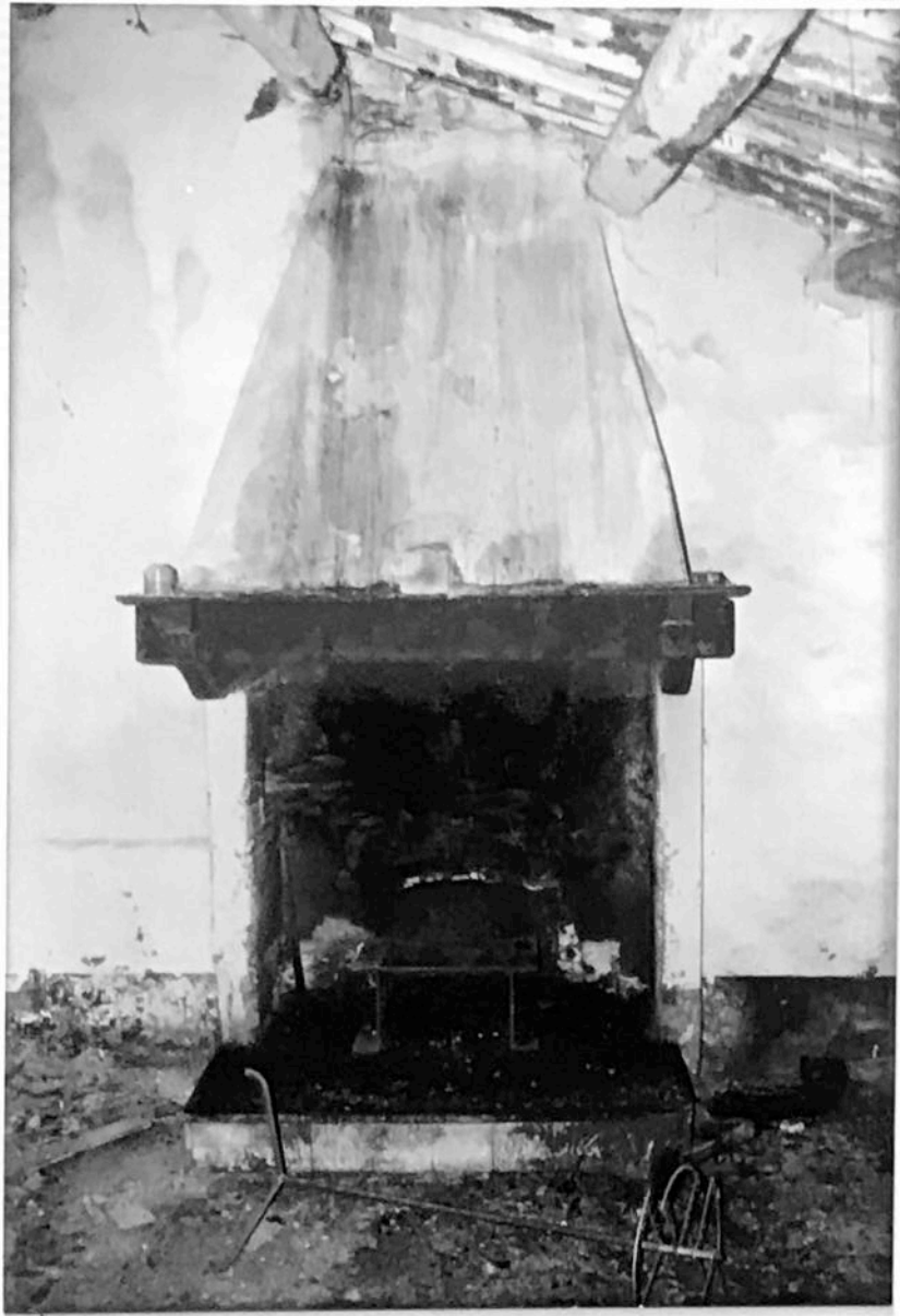
FOTO n°17 VOC.LA BUCA CAMINO
